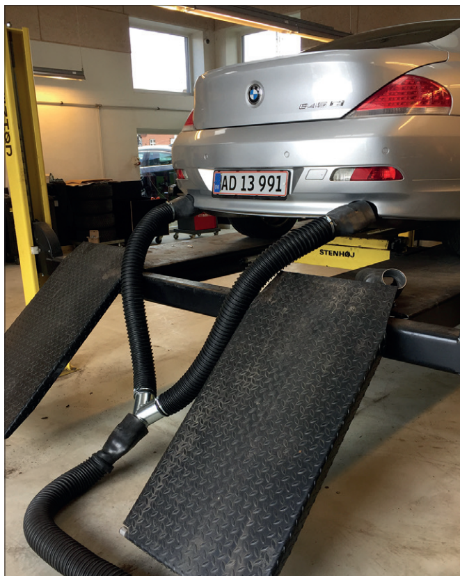
Her ses Y-kobling i brug
